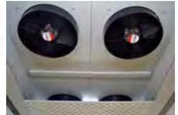
Havalandırma Sistemi Ventilation System
